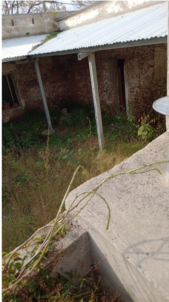
Foto 3 — Vista del patio y estructura edilicia deteriorada.
