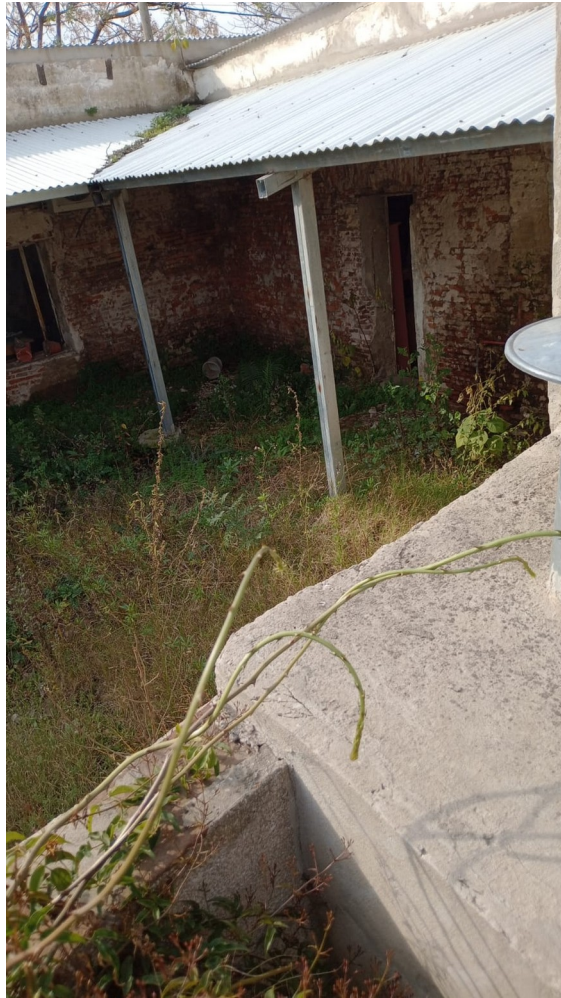
Foto 3 — Vista del patio y estructura edilicia deteriorada.
