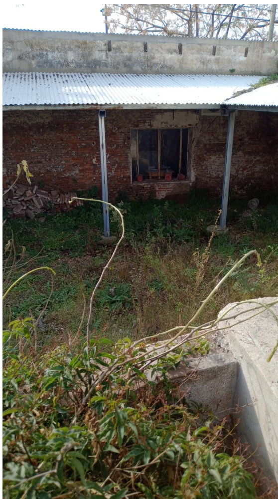
Foto 2 — Patio interno: acumulación de malezas y falta de mantenimiento.
