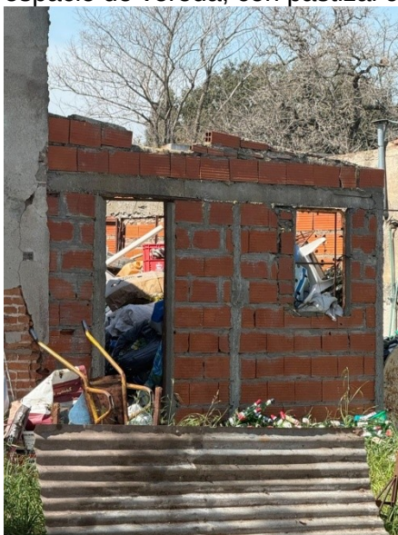
Foto 4: Interior de la construcción precaria con residuos, bolsas y envases acumulados.
